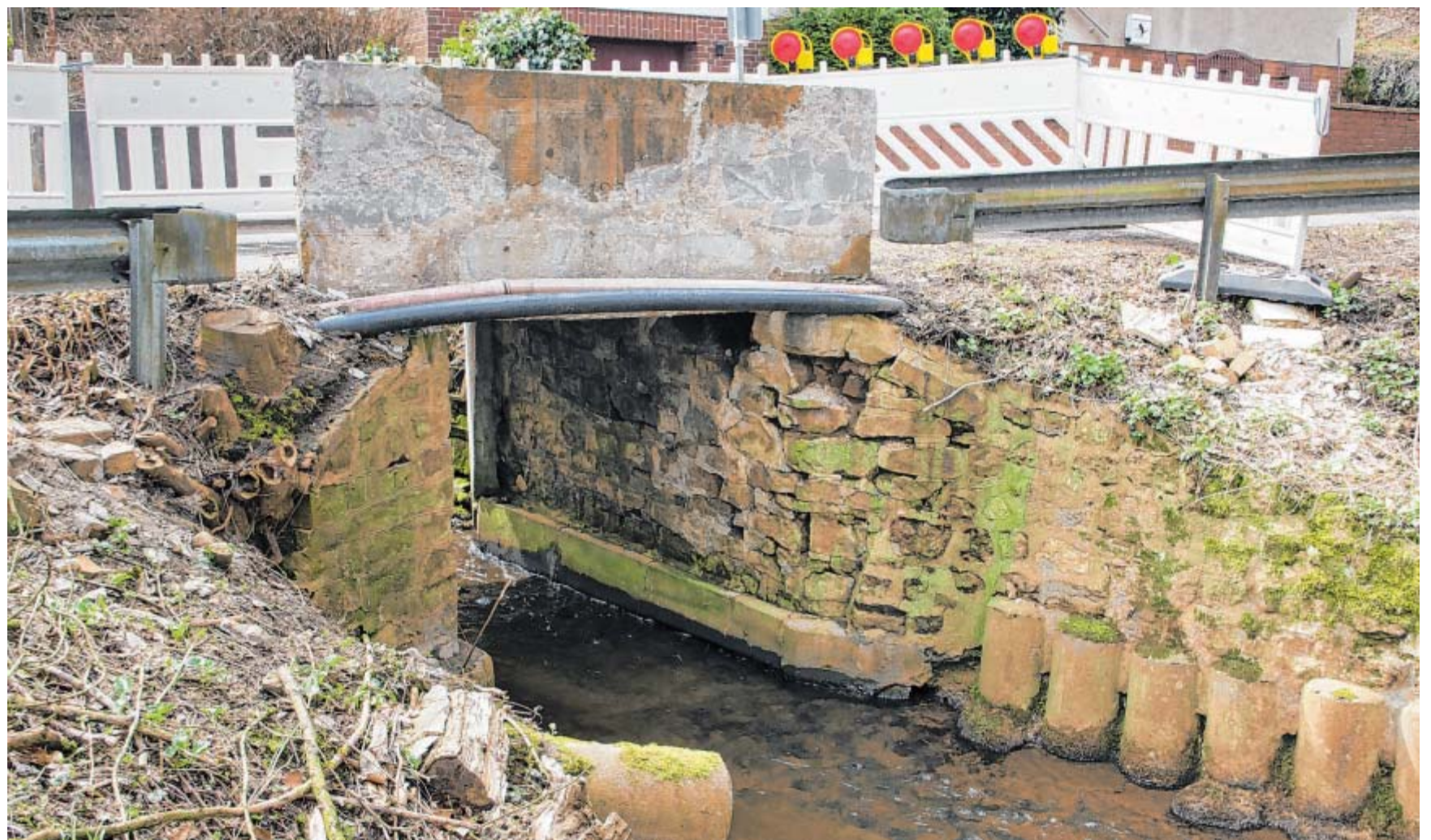
Schäden : An der Brücke in der Nähe des Bahnhofes Neues Mühle ist auch für den ungeübten Betrachter erkennbar, dass diese stark sanierungsbedürftig ist. Das Bauwerk gehört zu den drei Überwegen in Pr. Oldendorf, die neu gebaut werden müssen und bis dahin für Fahrzeuge gesperrt sind. FOTOS (3): CORNELIA MÜLLER
